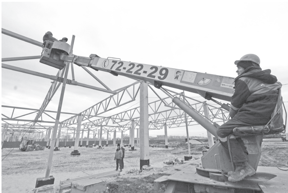
12.04.2016. Ульяновск, проспект Олимпийский. Строители еще только возводят кон- туры будущего гипермаркета. Спустя полгода он уже примет первых по- сетителей.
